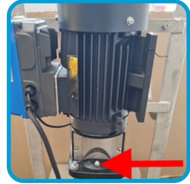
Figure 7 : Port de purge d'air
